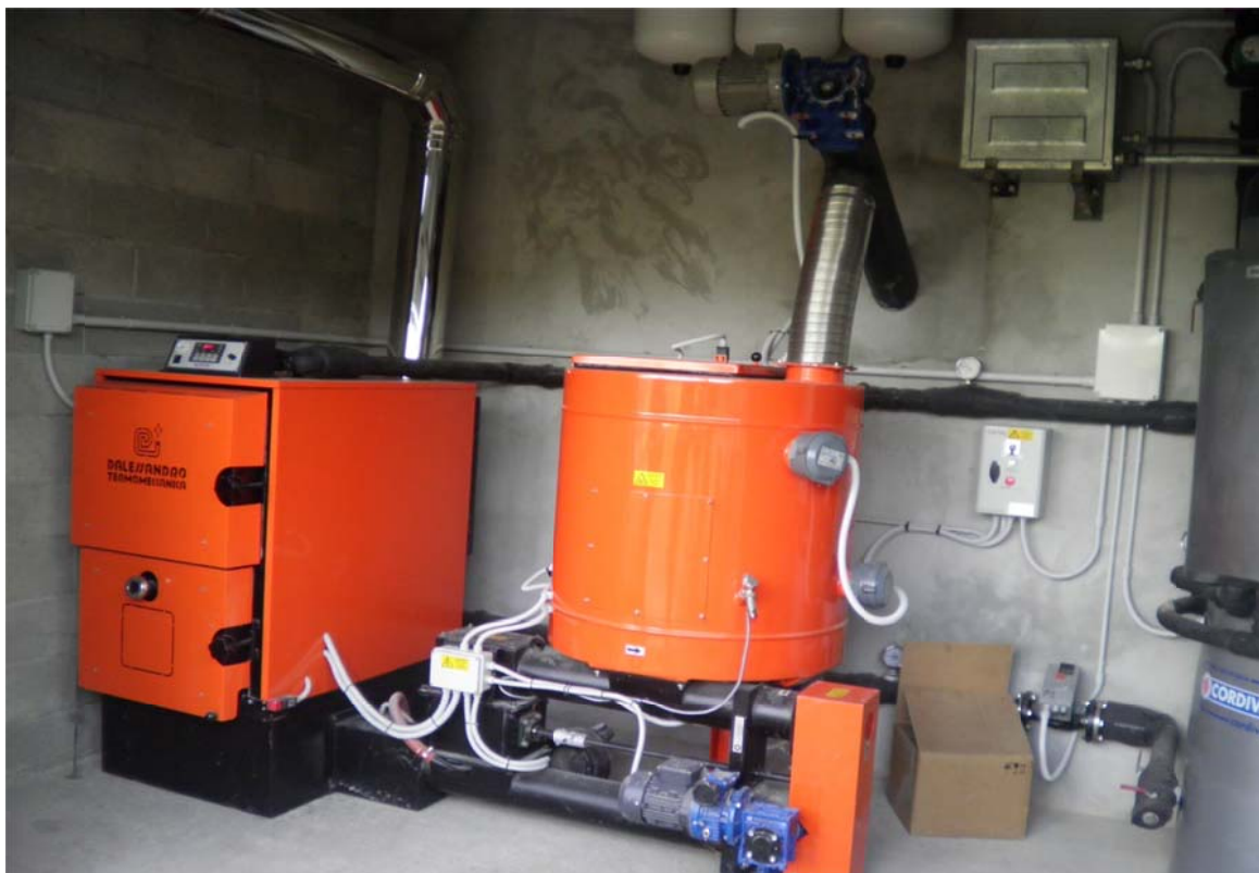
l'impianto a "cippato"
