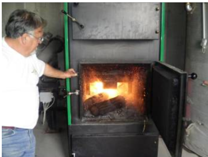
La caldaia a biomassa
