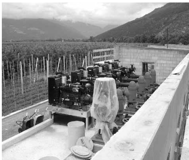
Gruppi di pompaggio di Cengles
