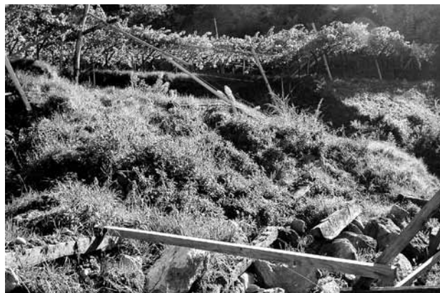
Crollo di un muro di sostegno in un vigneto
