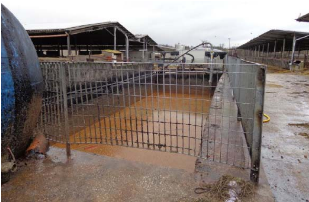
Vasca per la raccolta dei liquami prima dell'immissione nei digestori anaerobici
