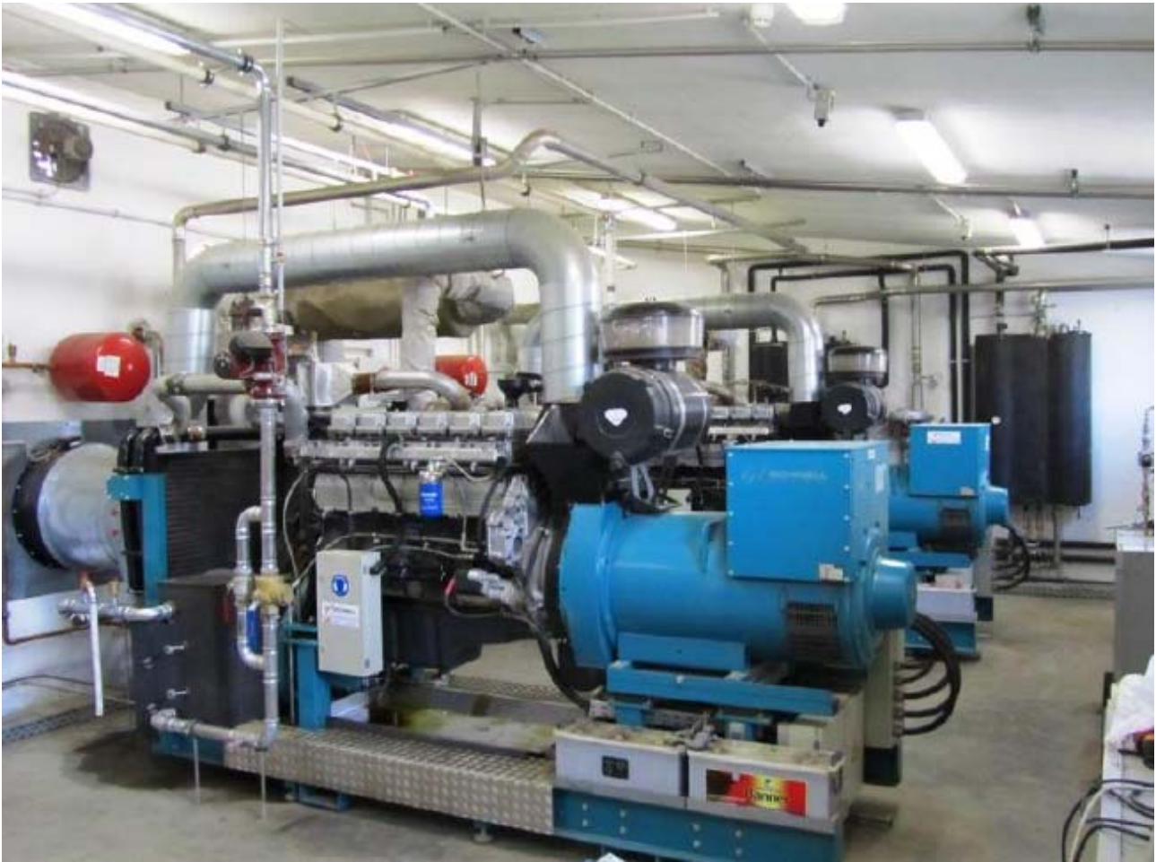
Modulo di 250 kWe per la produzione di energia elettrica e termica.
