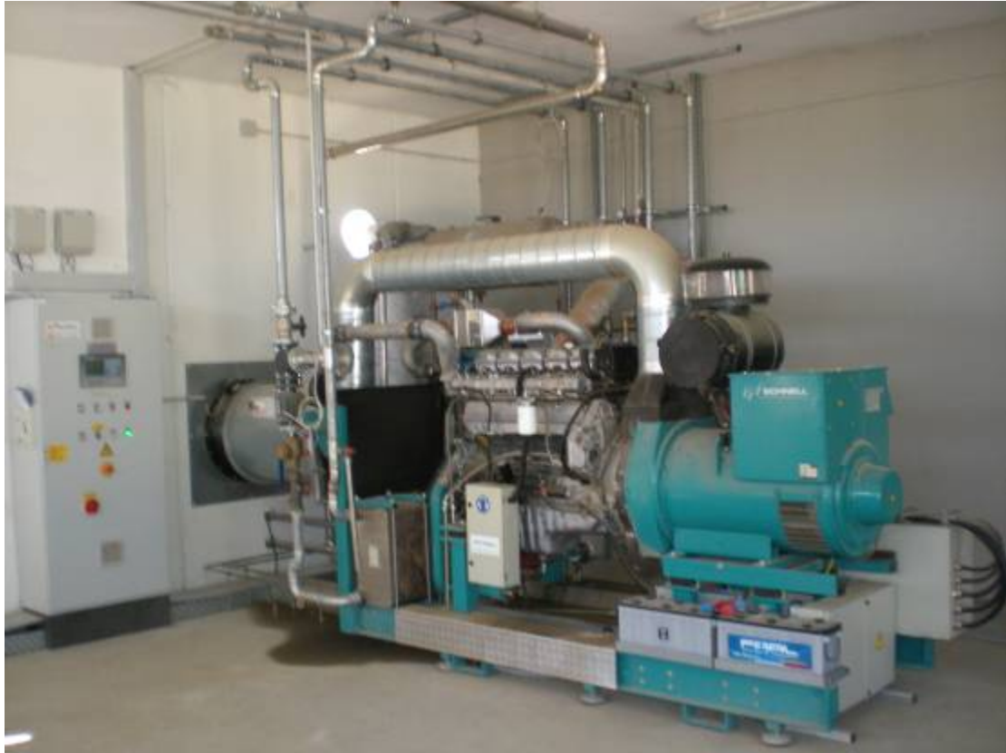
Modulo di 200 kWe per la produzione di energia elettrica e termica
